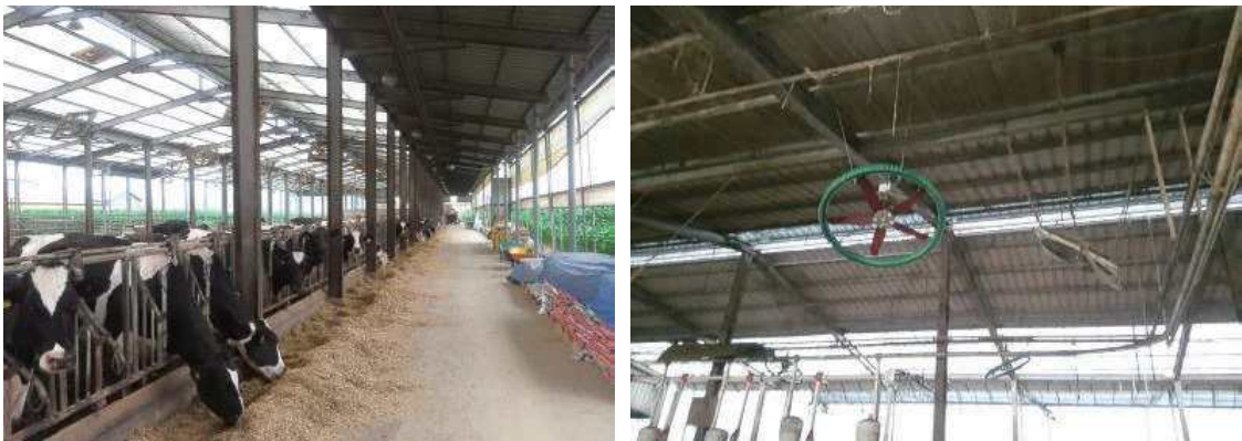
그림 3 유우사에 설치된 일반 송풍팬과 스마트 송풍팬
